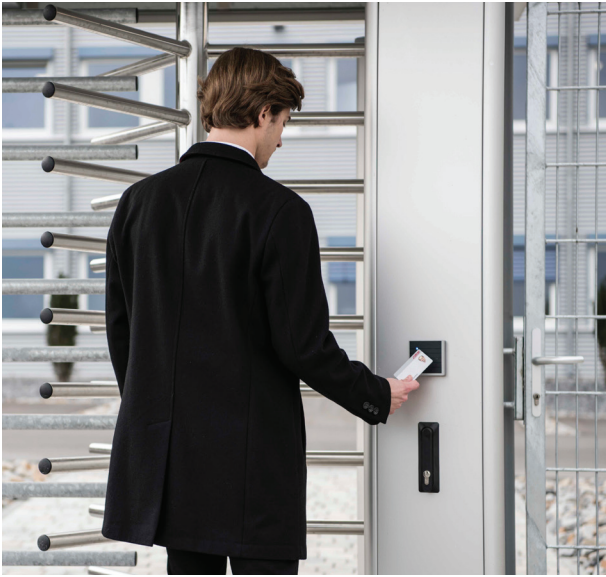
Bild: Zutrittssteuerung im Außenbereich mit Identifikation an einem RFID-Leser
